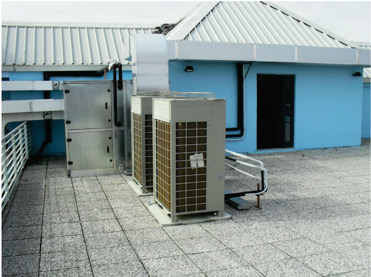
Figura 2 Posizione delle UTA in copertura
