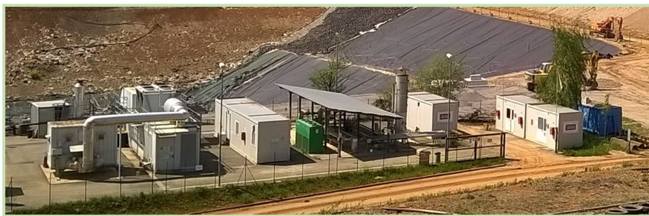
L'impianto di recupero energetico di Asja Ambiente Italia
