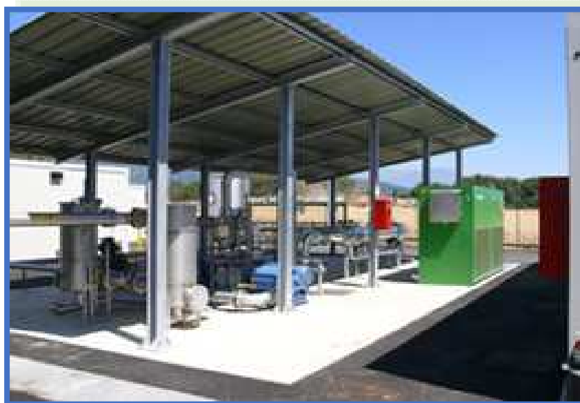
L'impianto a biogas di Grosso
